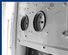
Нестандартные электрораспределительные устройства
